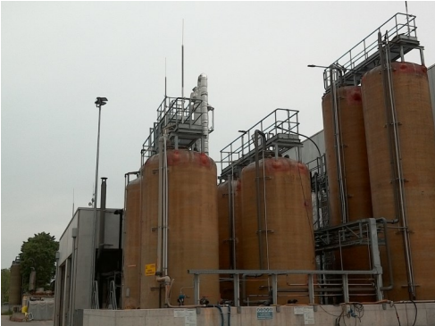
Impianto di trattamento del percolato
