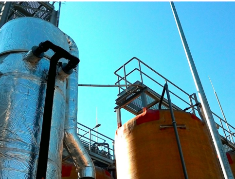
Impianto di trattamento del percolato
