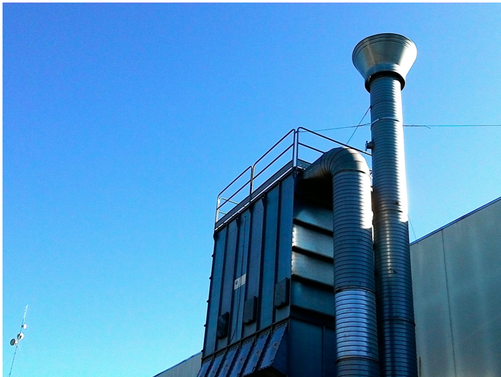
Filtro a maniche per il trattamento delle arie aspirate dall'impianto
